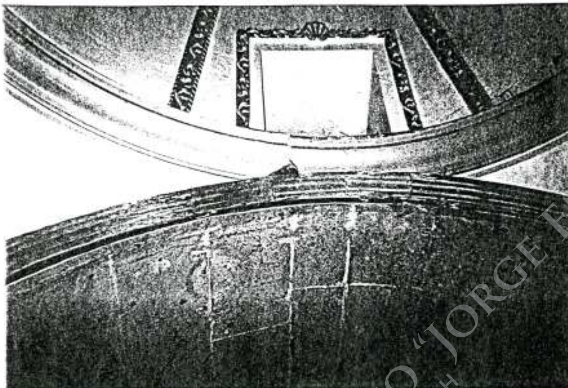
Interior del crucero, se aprecia arco de desplante y arranque de la cúpula. grietas horizontales paralelas al anillo de compresión. Junio 2000.
